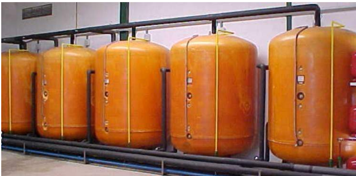
Figura 96: Distribución de varios acumuladores en un local técnico
