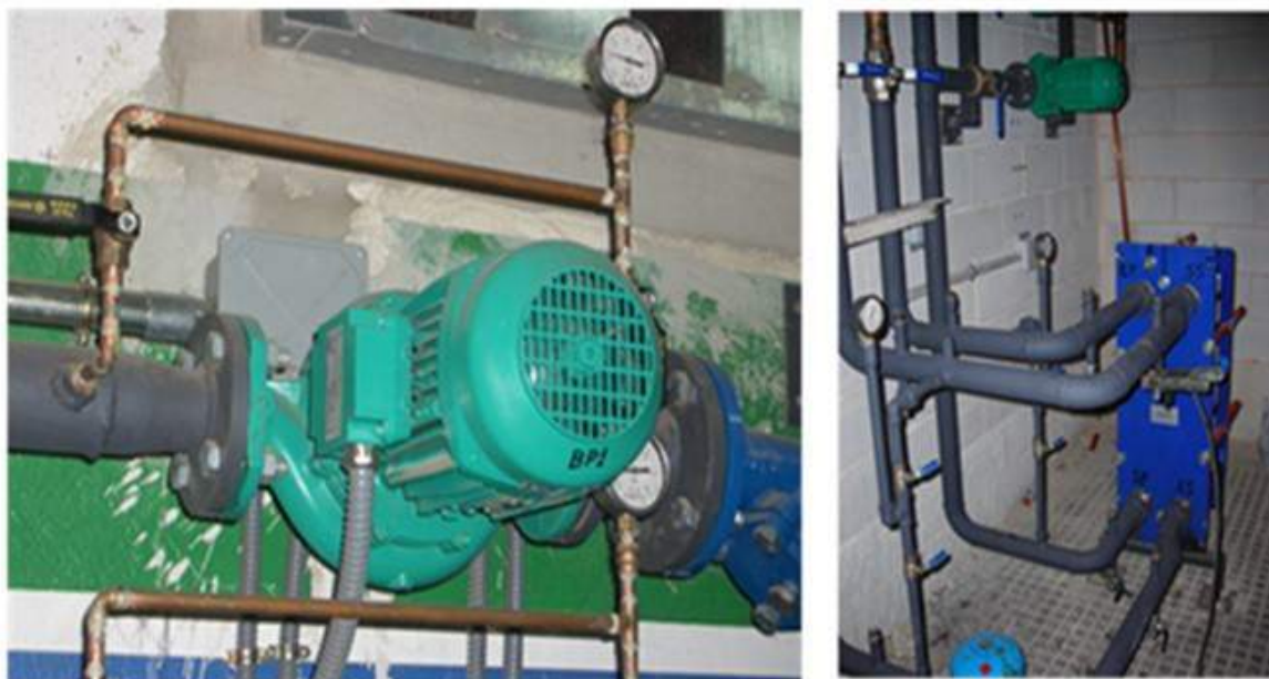
Figura 85: Puentes manométricos para medida de presión diferencial en bomba (izq.) e intercambiador (der.)
