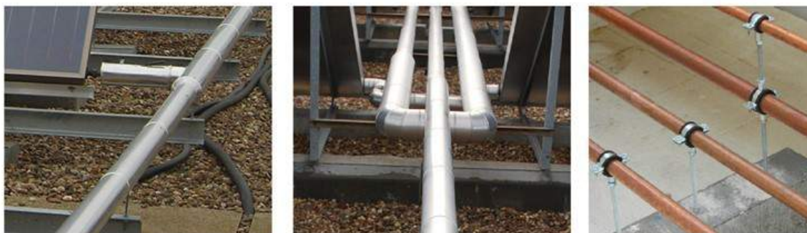
Figura 99: Varios ejemplos de soportes de tuberías y soluciones de acabado en chapa de aluminio
