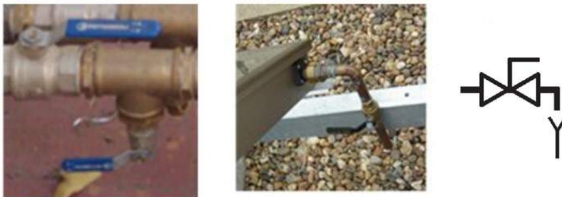
Figura 79: Ejemplos de válvulas de vaciado instaladas y conducidas y símbolo habitualmente utilizado
