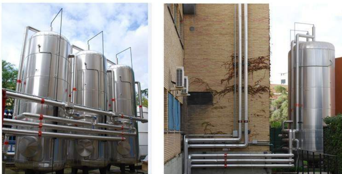
Figura 98: Montaje de acumuladores solares en el exterior y los circuitos hidráulicos que los conectan
