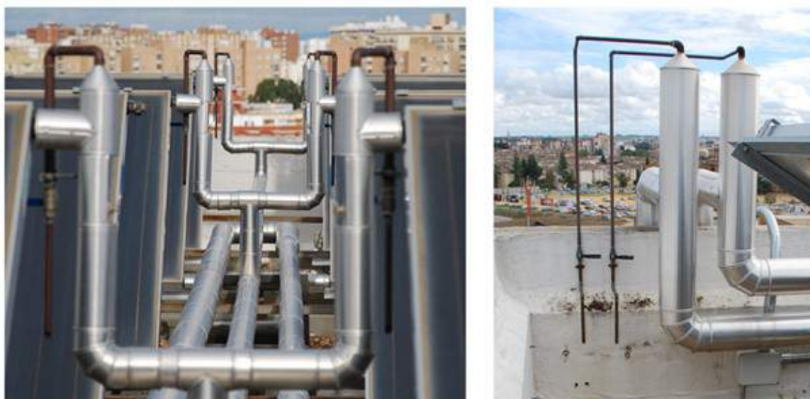
Figura 1: Ejemplos de circuitos primarios con purgadores manuales que mejoran la estanqueidad y facilitan las labores de mantenimiento
