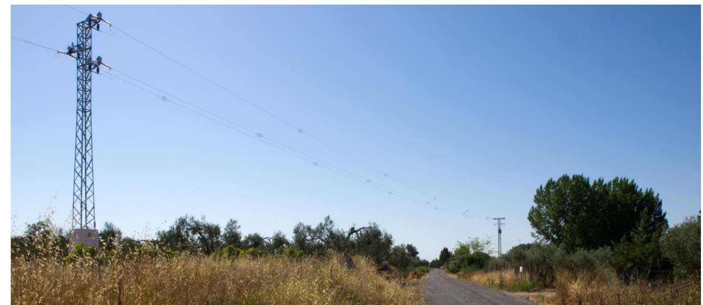
Figura 86- Fotografía Red Media Tensión, PK 14500 m.
