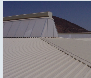
Aireador sobre estructura soporte de translúcido.
