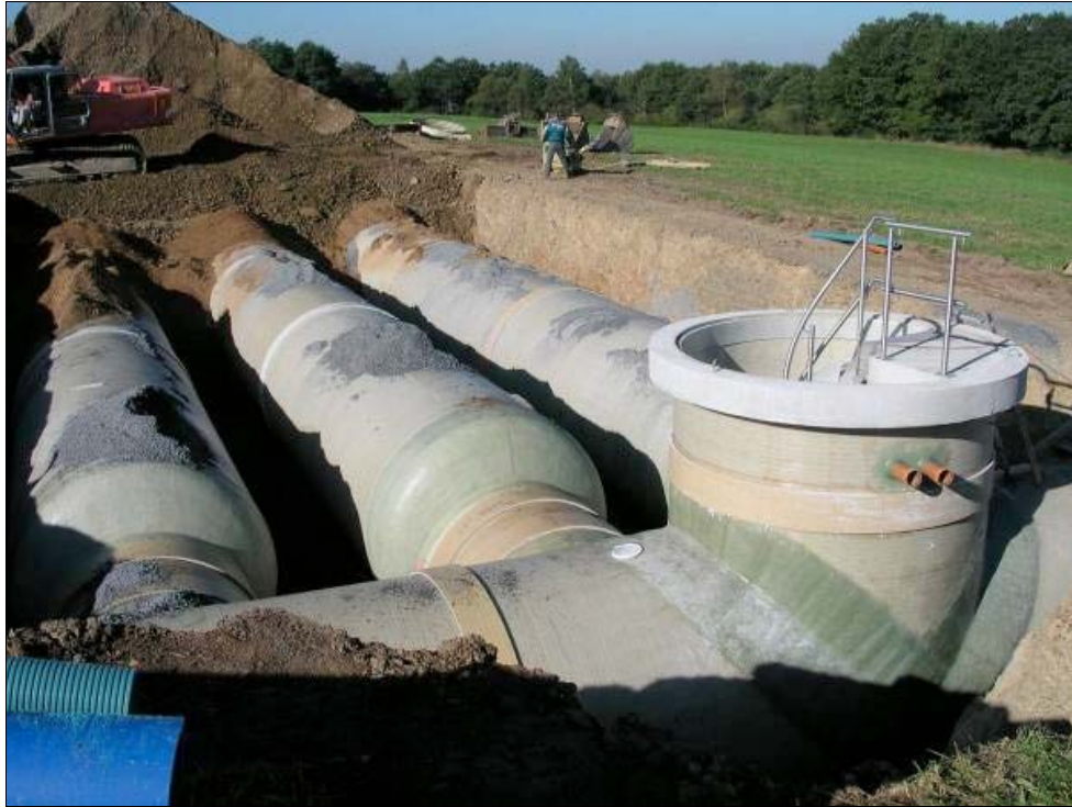
Fig. 16. Tanque de tormenta construido con conducciones de PRFV de gran diámetro
