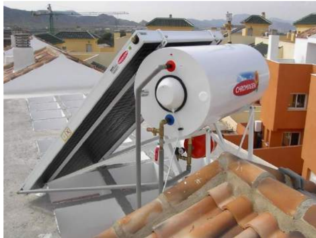
Figura 16. Depósito de acumulación.
