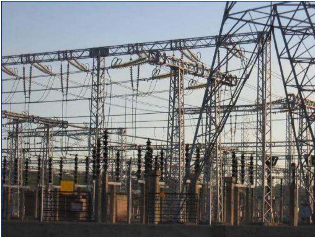
Ilustración 2-2: Subestación de interperie tipo AIS.
